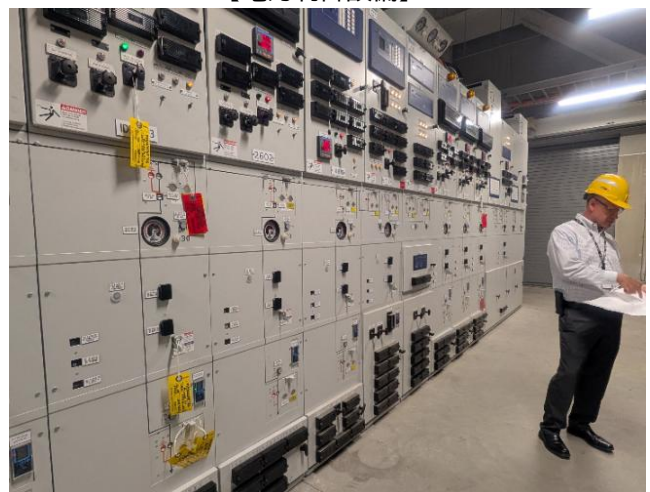
【電力制御設備】
